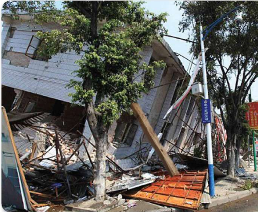
الشكل 16-7 المباني الخرسانية (الأسمنتية) هشة غالباً، ويمكن أن تلتف بسهولة إذا وقع زلزال؛ فالمبنى الظاهر في الصورة أزيح من فوق أساسه عندما حدث الزلزال، وتم إنساده بعمود من الخشب.
