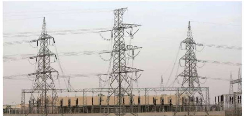
محطة سدير لتحويل الكهرباء
